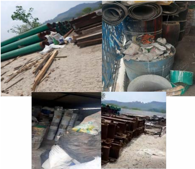
Figura 2. Inspección visual de los residuos generados
